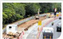
金獎 粉嶺公路介乎通曉粉嶺站至和興路的隔音屏障工程
